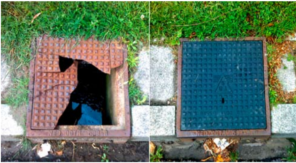
Een melding over een kapotte putdeksel en de situatie na reparatie
